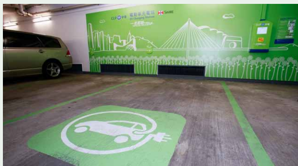
我們旗下辦公樓物業內的電動車充電設施
